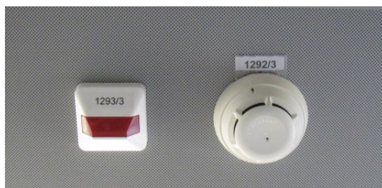
Slika 21: Avtomatski javljalniki požara (desno) in indikator javljalnika (levo)
