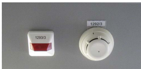
Slika 19: Avtomatski javljalniki požara (desno) in indikator javljalnika (levo)
