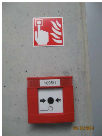
Slika 20: Ročni javljalniki požara
