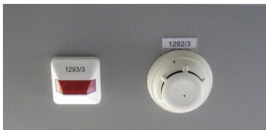
Slika 18: Avtomatski javljalniki požara (desno) in indikator javljalnika (levo)
