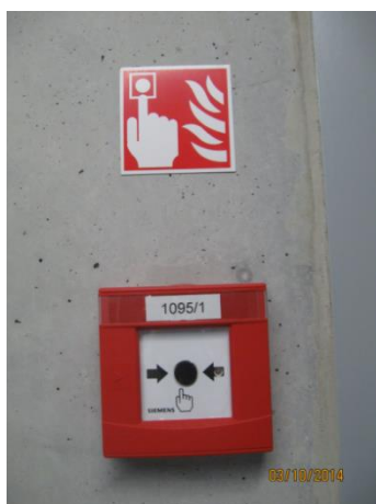
Slika 19: Ročni javljalniki požara
