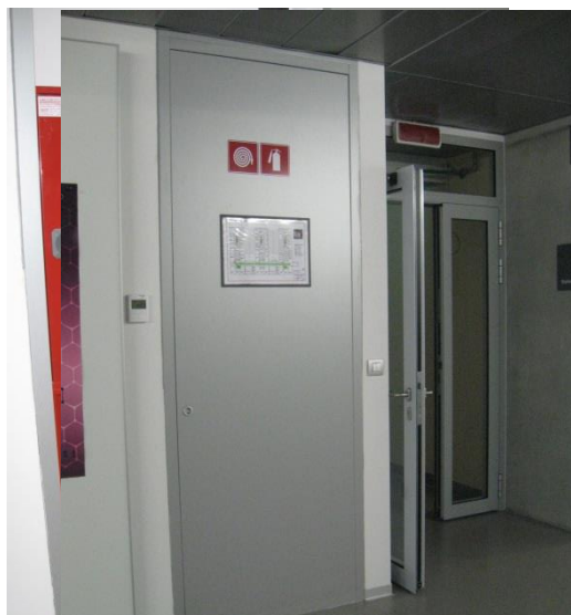
Slika 23: Omara, v kateri so nameščeni hidrant in gasilnika
